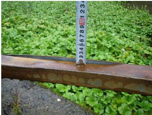
図 4-1 レール損傷状況
