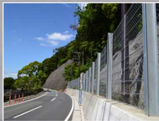
設置状況（静岡県沼津市）
