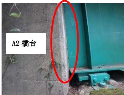
写真 3-1 主桁の遊間異常
