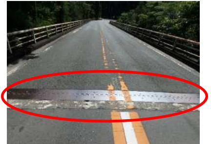
写真 3-3 伸縮装置の遊間異常
