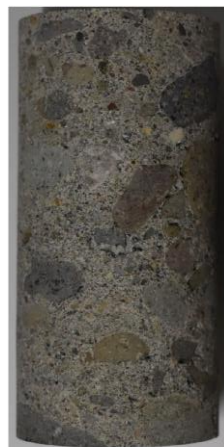
写真2. 短柱状コア (健全部)
