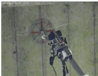
写真-17 クラックスケール あて 宛がい法
