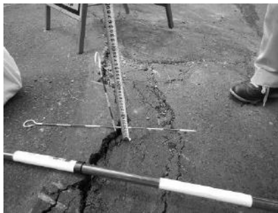
路面には段差亀裂約4cm、空洞約20cmが生じている
