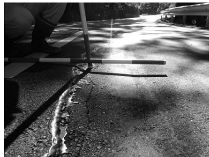
路面には約8cmの段差が生じている
