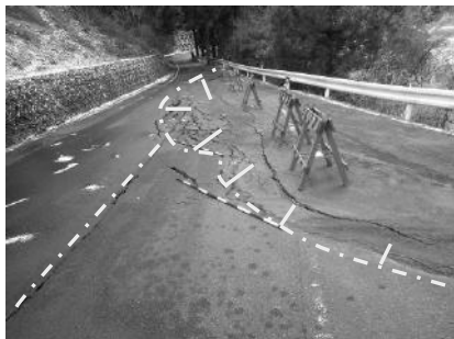
路面の谷側部が沈下し、亀裂が連続する
