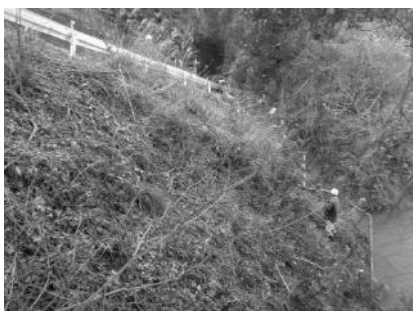
道路下の斜面は緩く、表面は凹凸が多い
