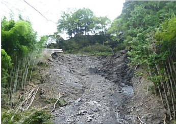
林道路肩崩壊状況
