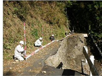
林道路肩崩壊状況
