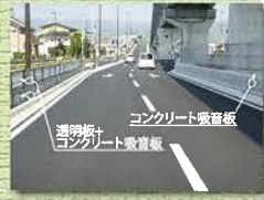
透明板と吸音板を組み合わせた多機能な遮音壁の採用
